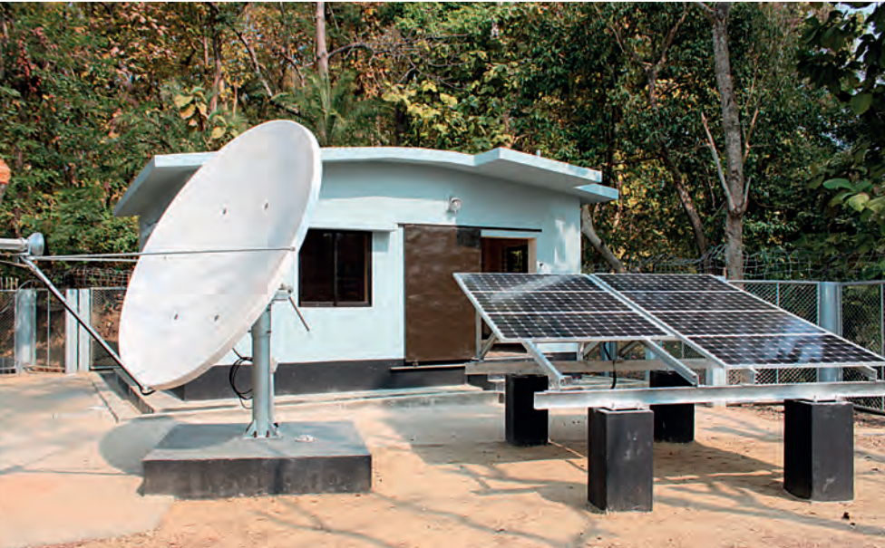
En haut: Station de surveillance hydroacoustique HA2, Îles de la Reine-Charlotte (Colombie-Britannique, Canada). Au milieu: Travaux de mise à niveau de la station de surveillance des infrasons IS18, à Qaanaaq (Groenland, Danemark), l'une des villes les plus septentrionales du monde. En bas: Station sismologique auxiliaire AS7, à Bariadhala (Chittagong, Bangladesh), 100 e station de ce type certifiée dans le cadre du SSI.
