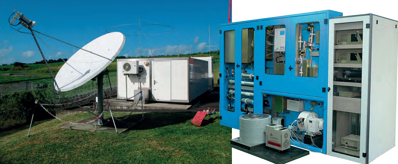
Station de surveillance des radionucléides RN29, sur l'île de la Réunion (France), dans l'océan Indien, à l'est de Madagascar. Cette station est équipée d'un système de surveillance des gaz rares de type SPALAX (à droite). Il s'agit là du premier système de type SPALAX certifié dans le cadre du SSI.
