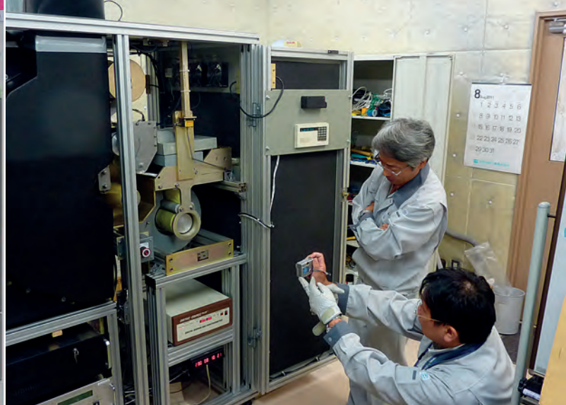
Opérateurs vérifiant l'installation du système de détection de la station RN38.
