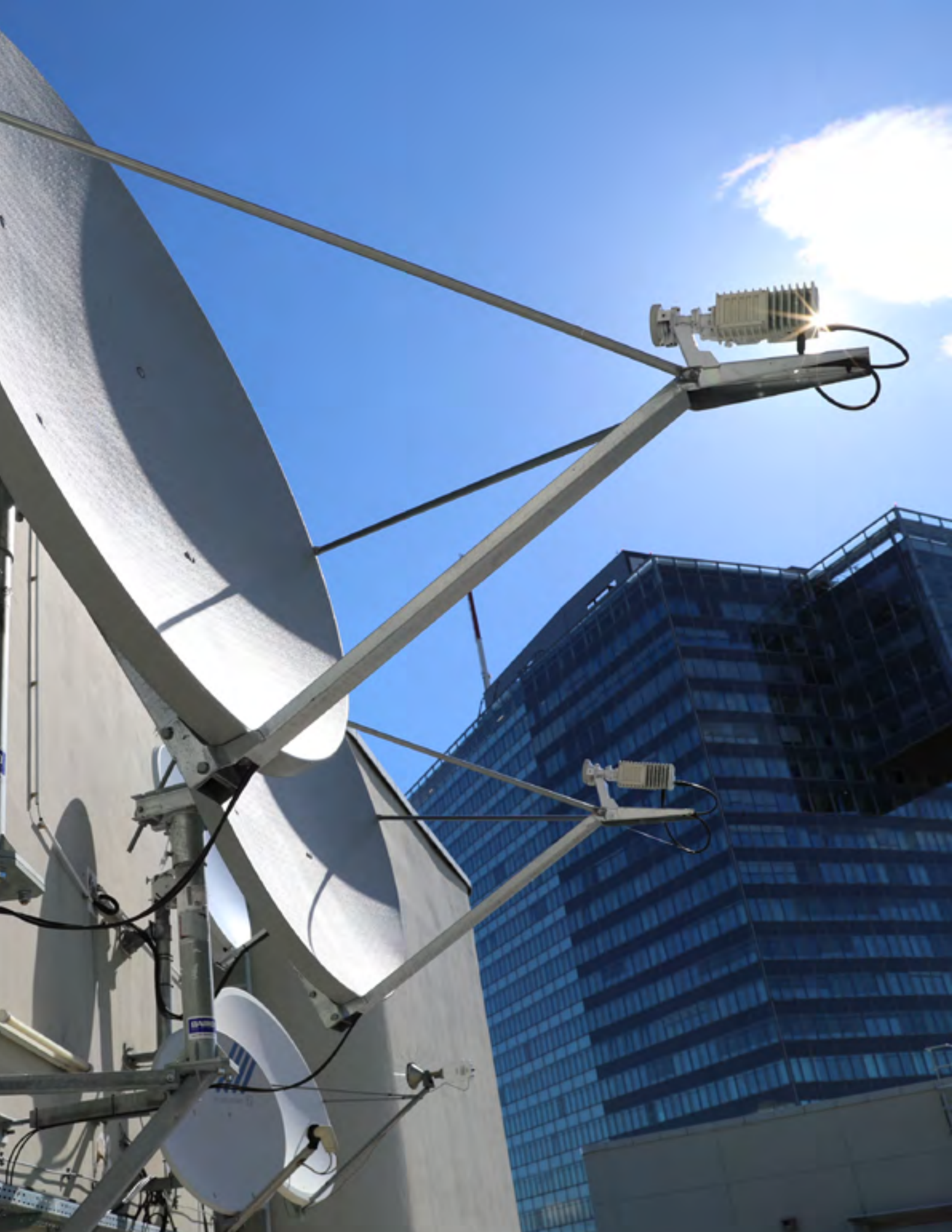
Оборудование ИГС-III, установленное на крыше Венского международного центра (Австрия)
