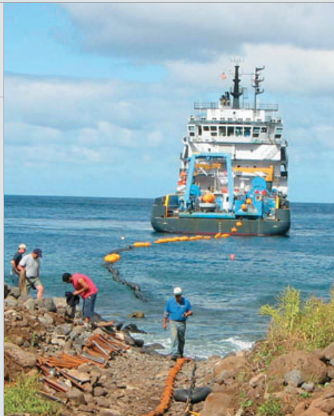
Прокладка кабеля от берега к гидроакустической станции НАЗ, остров Хуан-Фернандес, Чили. Буйки, удерживающие кабель на поверхности моря, затем снимаются с тем, чтобы кабель мог опуститься на морское дно.
