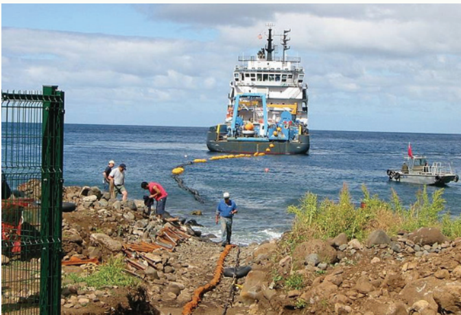
LA ESTACIÓN HIDROACÚSTICA HA03, EN EL ARCHIPIÉLAGO JUAN FERNÁNDEZ (CHILE), DURANTE SU CONSTRUCCIÓN. LA ESTACIÓN QUEDÓ DESTRUIDA EN FEBRERO DE 2010 POR UN TSUNAMI QUE ASOLÓ TODA LA ISLA.
