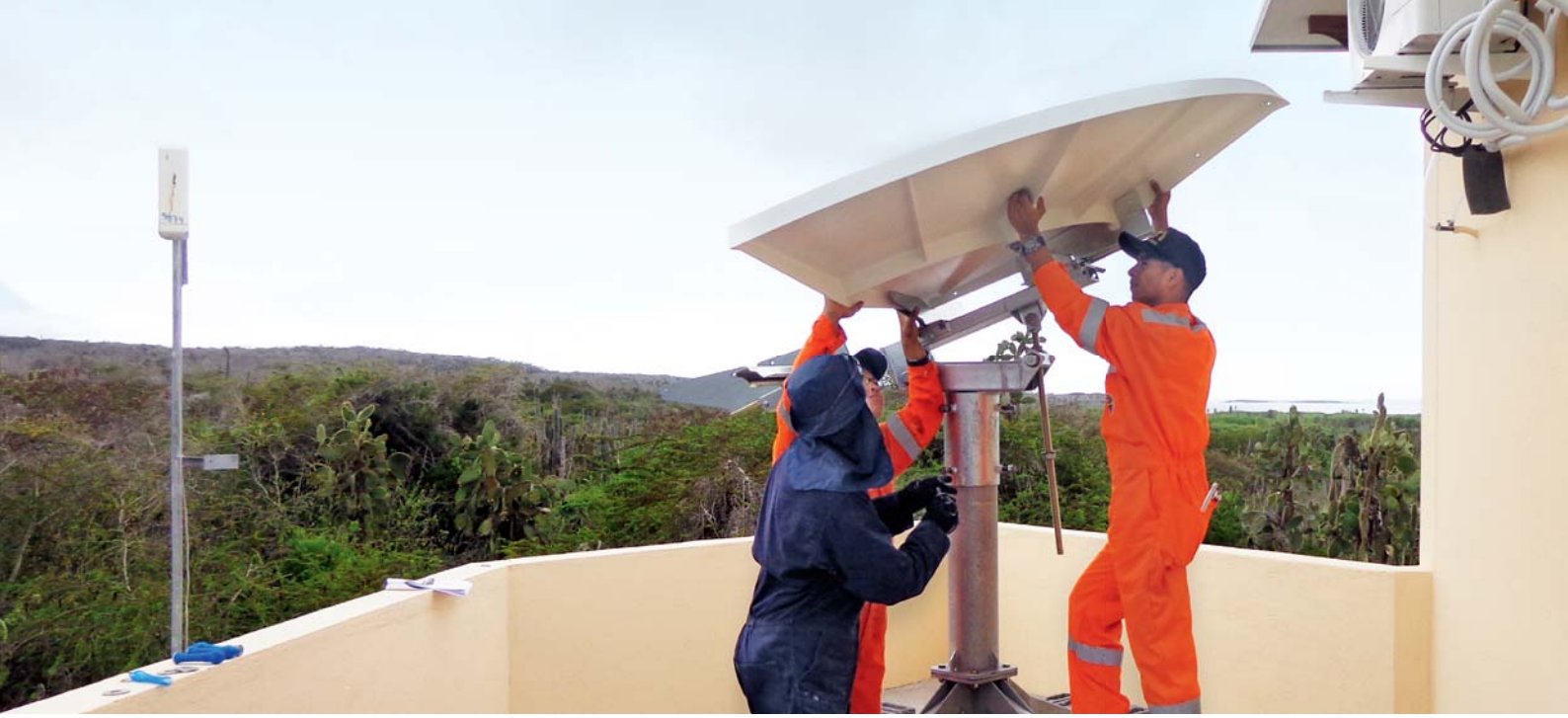
تركيب معدات محطة طرفية ذات فتحة صغيرة جدا في محطة رصد النويدات المشعة RN24، جزيرة سانتا كروز، جزر غالاباغوس (إكوادور).
