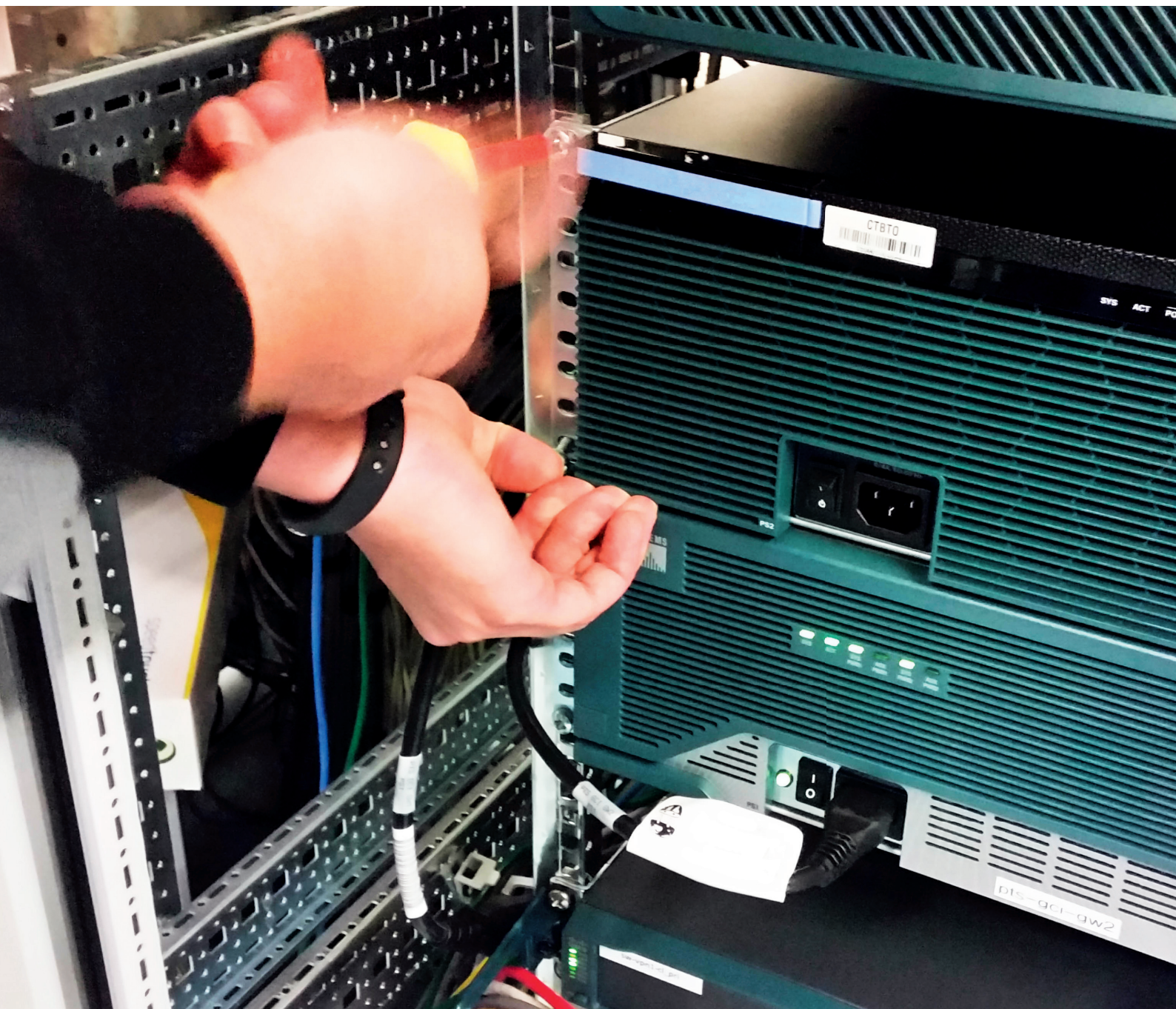
Installation de nouveau matériel destiné à l'ITM au centre de calcul de Vienne.
