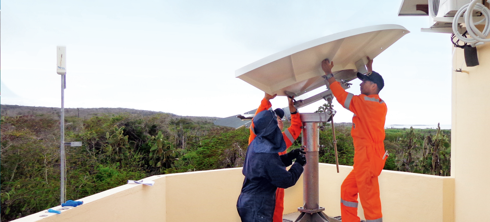
Installation de matériel VSAT à la station de surveillance des radionucléides RN24, île de Santa Cruz, archipel des Galápagos (Équateur).
