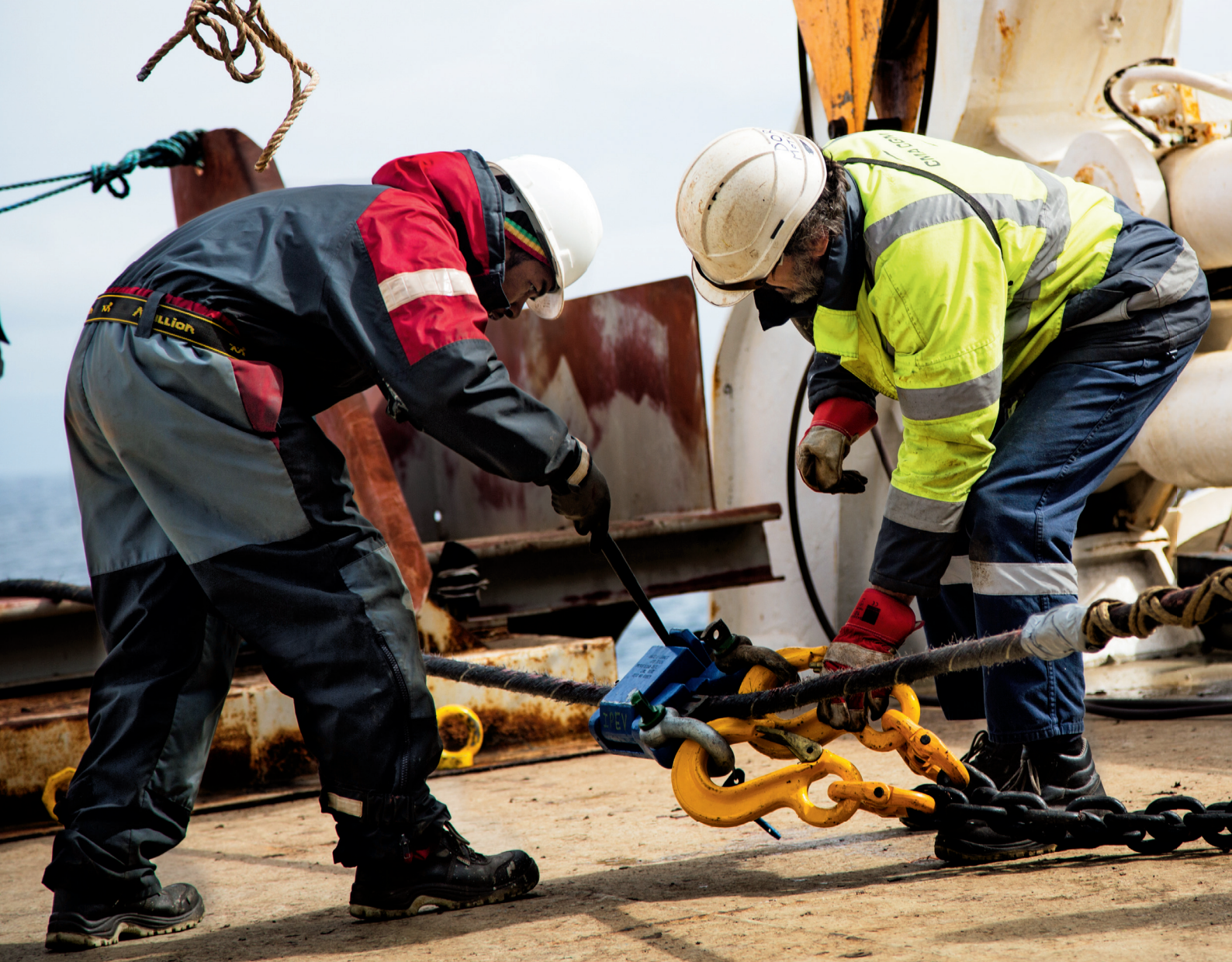
Installation de la station de surveillance hydroacoustique HA4, îles Crozet (France).
