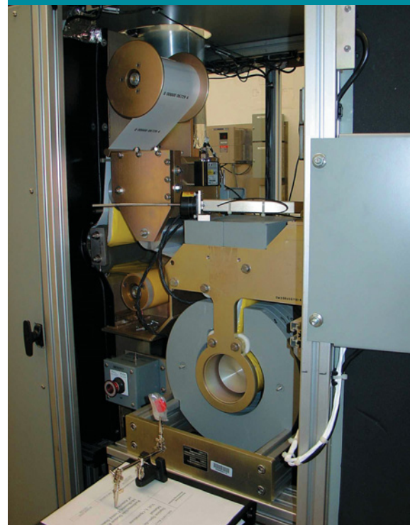
Verificación de un detector durante una visita de homologación a la estación de radionúclidos RN72, Melbourne, La Florida, EE.UU.
