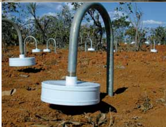
Фрагмент впускного канала системы шумоподавления инфразвуковой станции IS7 в Варрамунге (Северная территория, Австралия).
