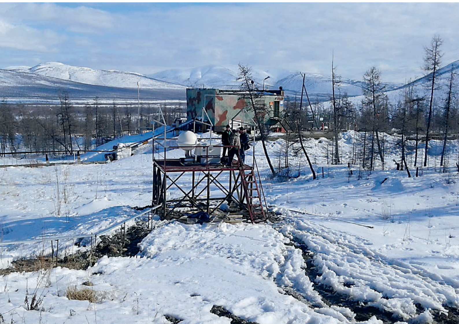
Installation et certification de la station de surveillance des radionucléides RN57 (Fédération de Russie).
