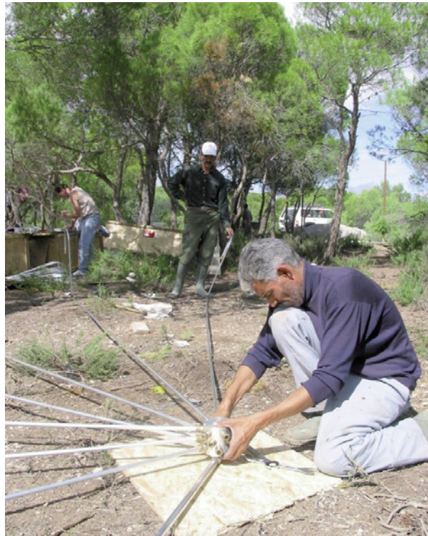
Первичный монтаж поставленной ВТС сборной волноводной решетки, инфразвуковая станция IS48, Кесра, Тунис.
