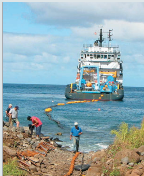
在智利胡安·费尔南德斯岛水声台站 HA3 铺设近海岸电缆。在海面扶持电缆的浮漂随后去除,以便电缆沉入海底。
